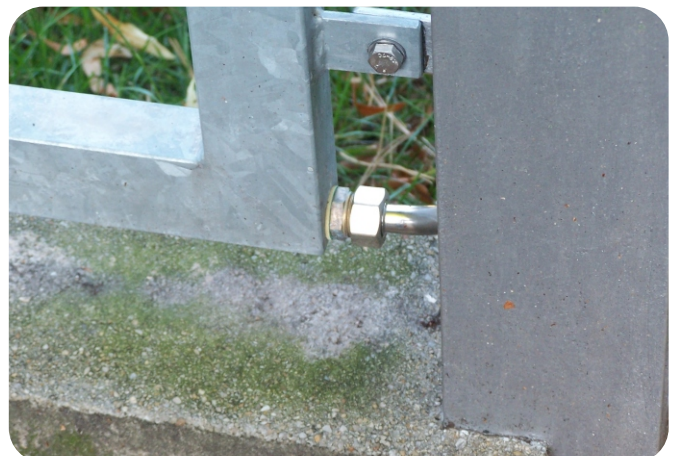
Kollektoranbindung am Zaunspfahl
