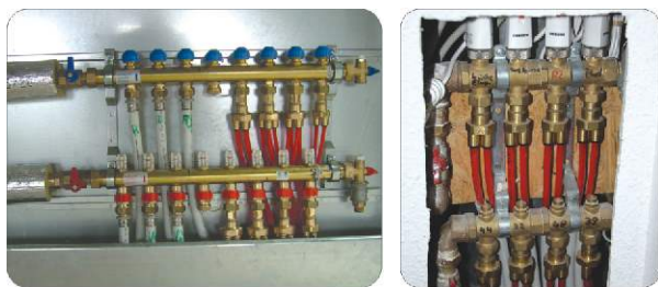
Anschluss der Heizrohre an Unterverteiler mit Steckanschlüssen
